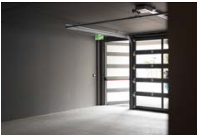
SR Panorama con griglie areazione e portina di servizio SR Panorama with access door and ventilation grids
